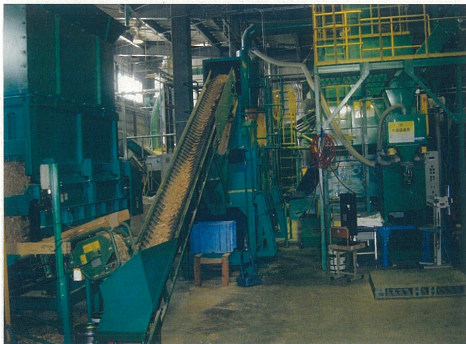
伊達市木質ペレットプラント内部
